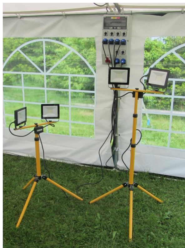
Spínací rozvaděč a vnější světla:
